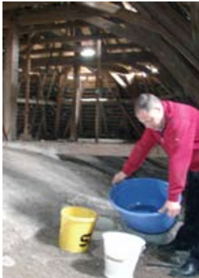
Fr. Alexander M. sammelt in Kübeln das Regenwasser; das Kirchendach ist an vielen Stellen undicht.
